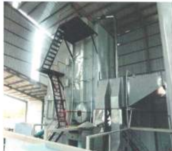
Dự án cấp nhiệt công suất: 15 tấn/giờ Công ty Cao Su Mai Vinh
