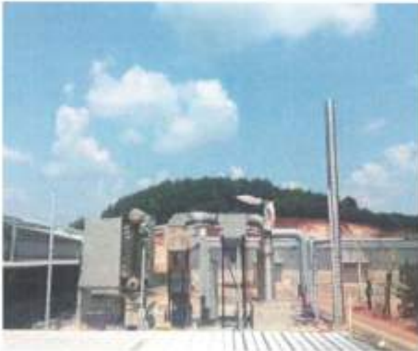
Dự án cấp nhiệt công suất: 20 tấn/giờ Công ty TNHH Linh Hương
